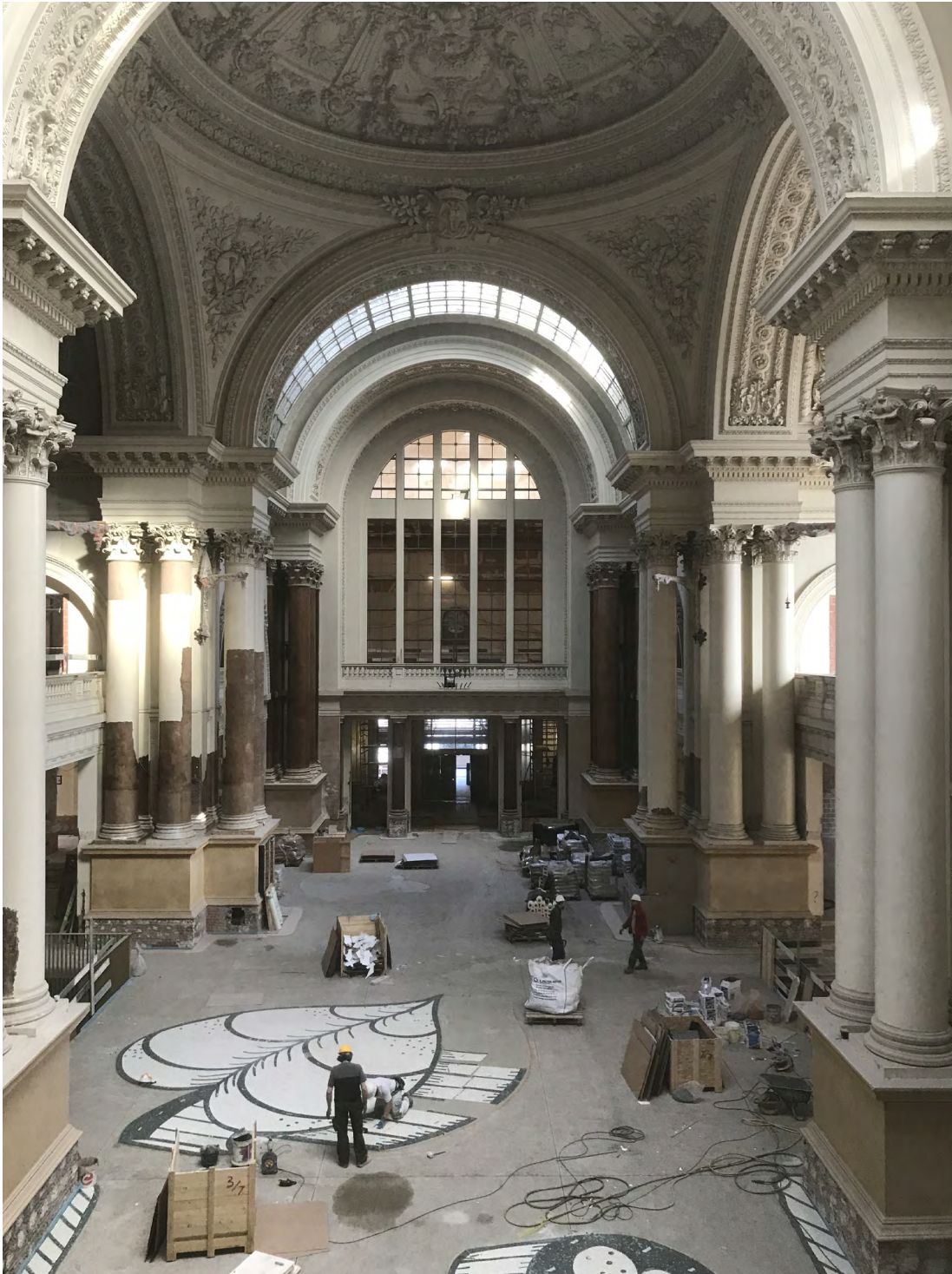
Ir. Architect op werf Beurs Brussel, Robbrecht en Daem architecten, kunstintegratie Valérie Mannaerts, werkbeeld mei 2022
